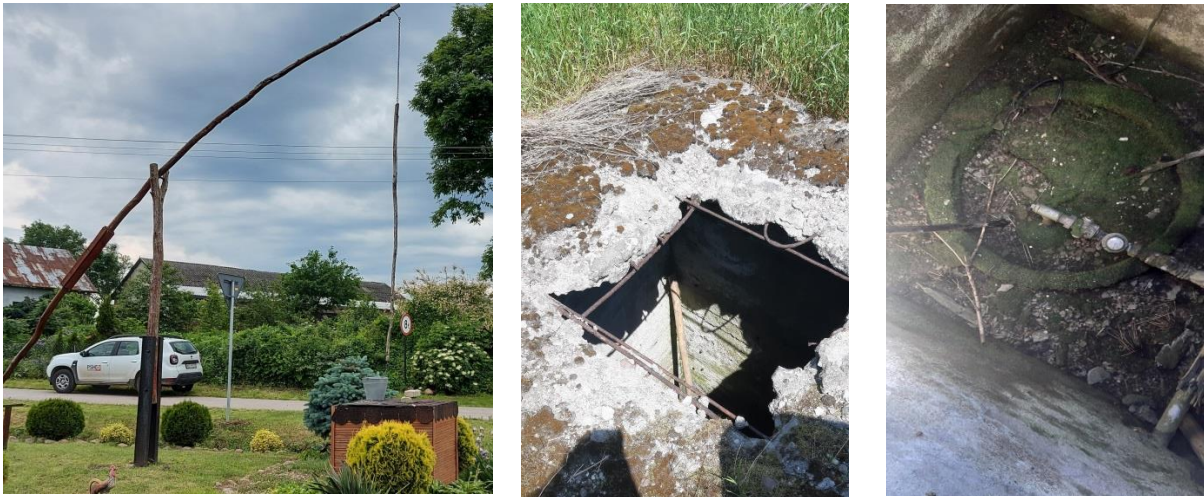
Ryc. 4 Stan techniczny studni kopanych i wierconych w obrębie arkusza Przasnysz
